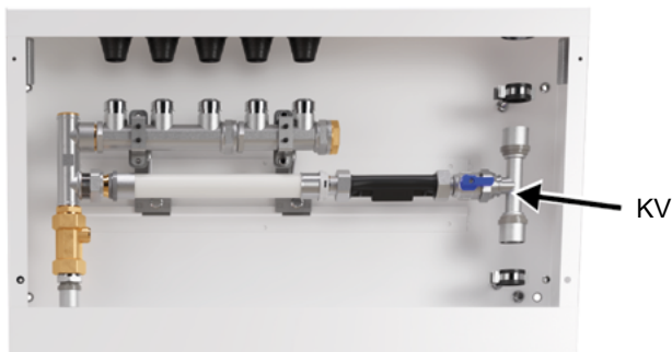
Separat fordelerskap for KV. Avløp munner ut i bunnen av varmeskapet.
