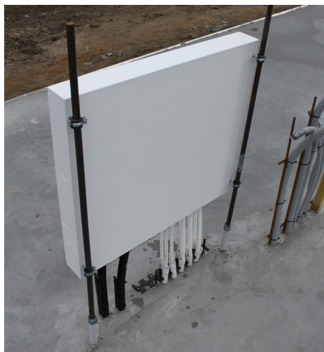
Montert skapstativ L2.
