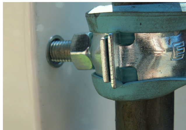
Nærbilde av festing mot skap
