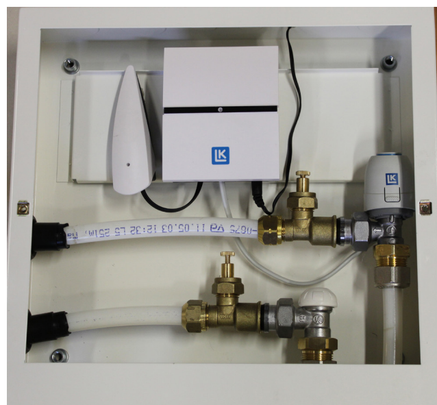
LK 1-Kretssats komplettert med LK Tilkoblingsset VKF RF/ 1-kretssats samt LK ICS-RF1. Utstyret er montert i LK Innbyggingskap M5 VT-XL.
