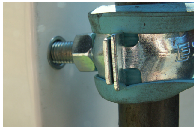
Nærbilde av festing mot skap
