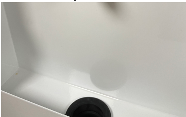
Rørgjennomføring nederst på innsiden av skapet.
