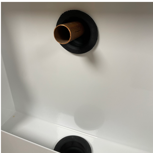
Innsiden av skapet med rørgjennomføringen og kobberøret.
