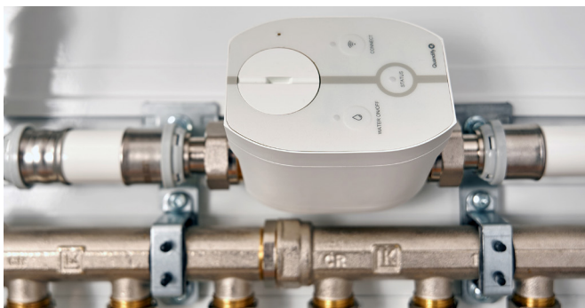
LK CubicSecure installert i et fordelerskap.
