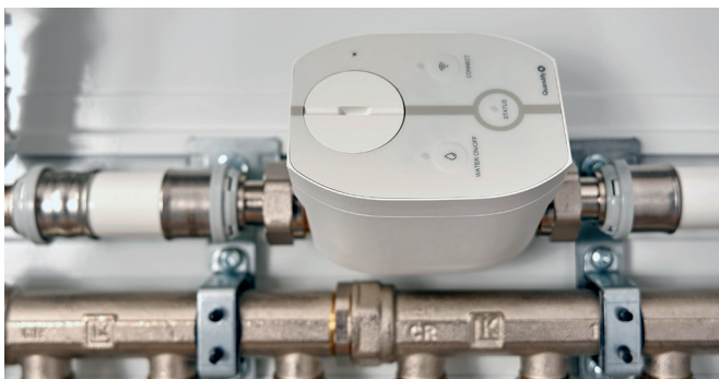
LK CubicSecure installert i et fordelerskap.
